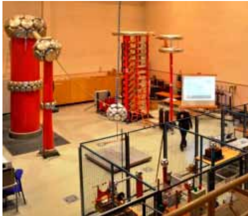
Die Hochspannungshalle der Hochschule
